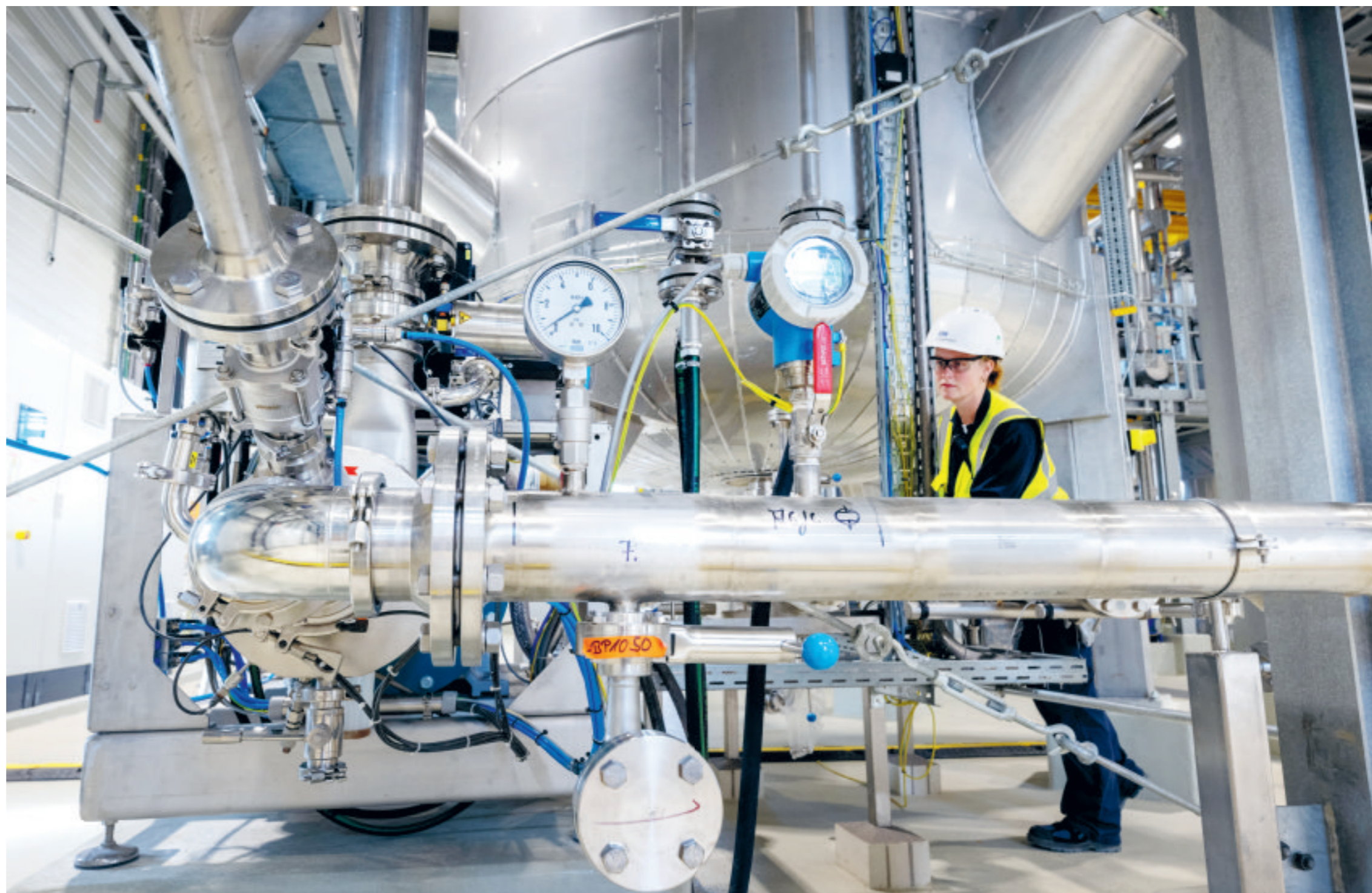
Lithiumraffinaderij van grondstoffenbedrijf AMG in de Duitse deelstaat Saksen-Anhalt. Lithium is een belangrijke grondstof voor de productie van batterijen voor elektrische auto's.
